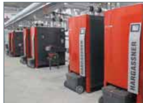
Cascade de 6 chaudières de 200 kW
