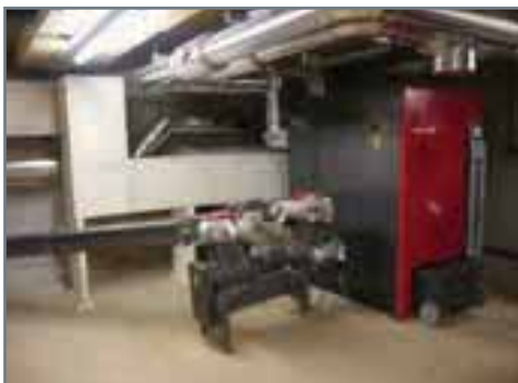
Chaudière de 200 kW avec 2 vis entrée chaudière
