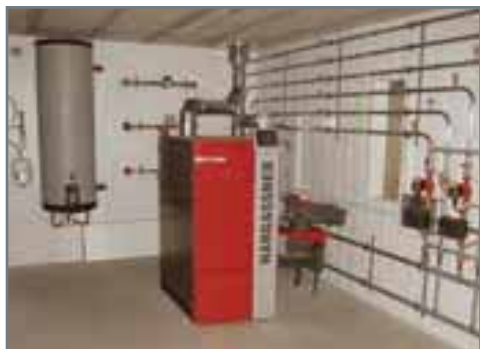
Chaudière EcoHK de 35 kW avec Production d'ECS
