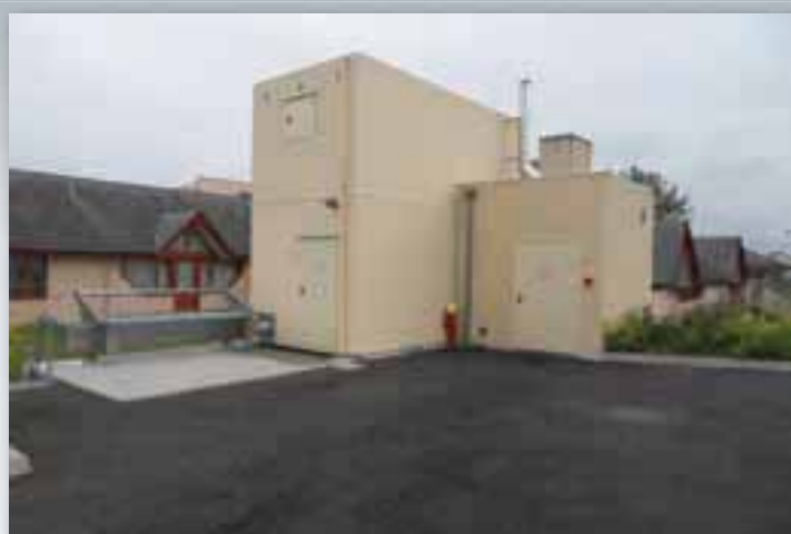
Container double pour un réseau de chauffage collectif.
